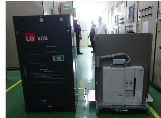
④ 신품 Retrofit VCB 육안검사
