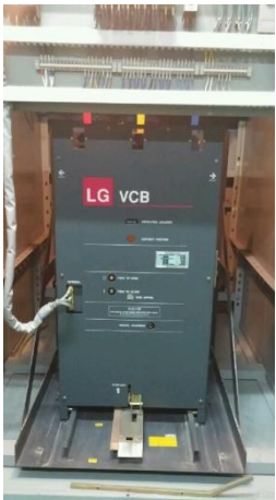
① 24kV 25KA VCB 인출
