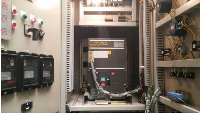
① 7.2kV 25KA VCB - '95년 6월 제품
