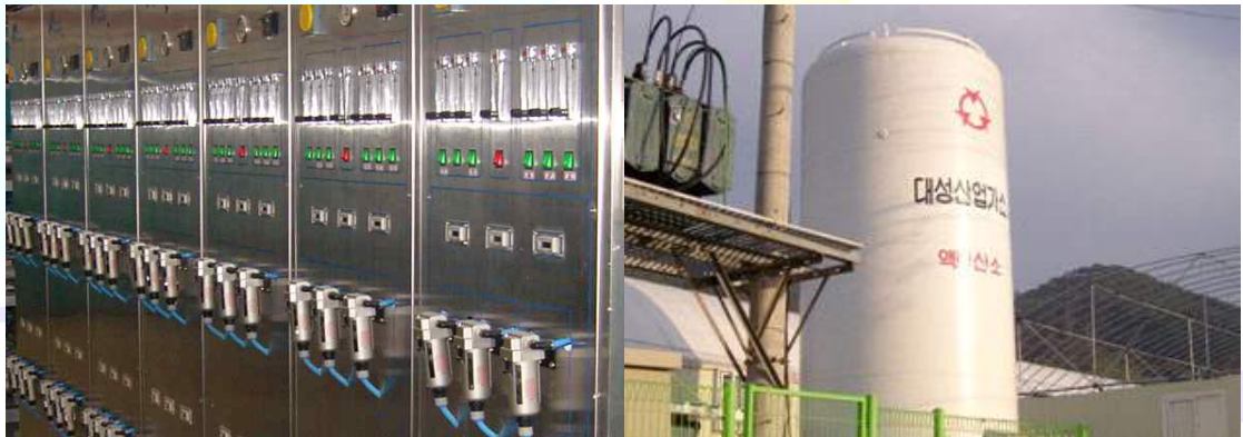
<Fig.>산소발생기 및 액화산소 저장탱크
